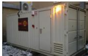
ЛИА ИБП/СНЭ ГРБ№25 г.Санкт-Петербург
