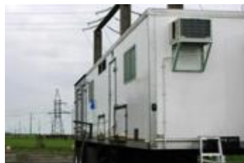
ИБП и СНЭ ОАО ФСК ЕЭС
